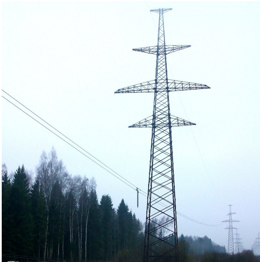
Рисунок 7 - Обрыв и падение гирлянды изоляторов на два провода фазы двухцепной ВЛ 330 кВ «Гатчинская – Лужская»
