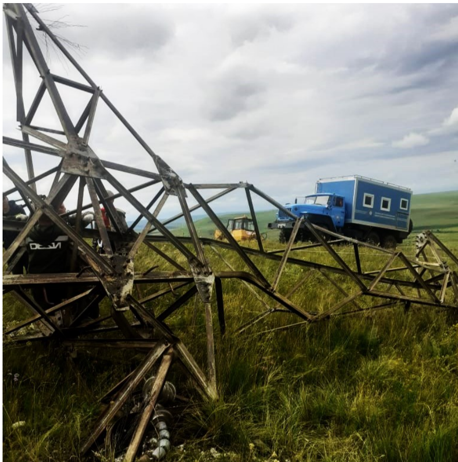
Рисунок 8 - Падение промежуточной стальной опоры на ВЛ 220 кВ (1987) в Забайкалье от небольших ветровых нагрузок, ослабленной вандальным снятием нижних раскосов
