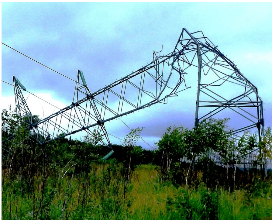
Рисунок 1 - Групповая авария на участке двухцепной ВЛ 220 кВ «Дорохово – Слобода 1,2» №№ 57-60 с падением промежуточной опоры № 60 и аварийным повреждением соседних трех промежуточных опор №№ 57-59 в Подмоскowie
