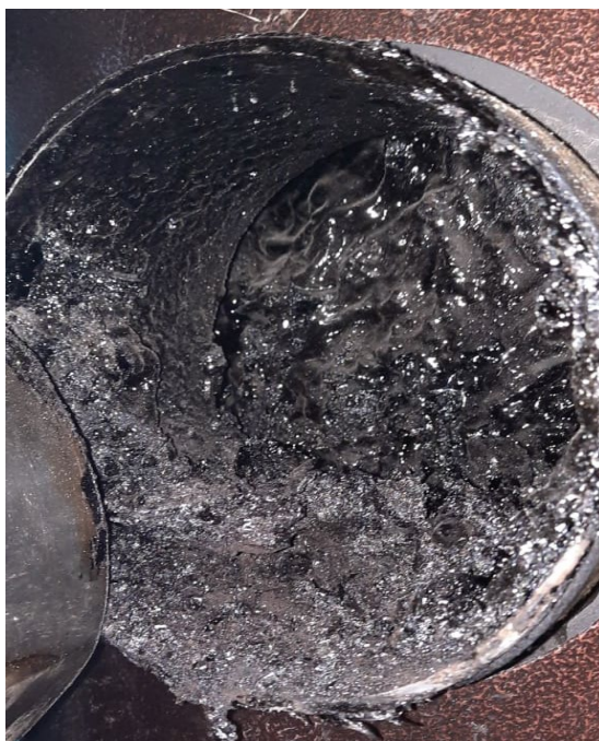
Рис. 1 – Процесс сажеобразования в полости дымохода котла
