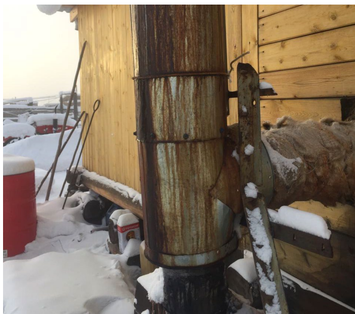
Рис. 2 – Процесс образования кислотного конденсата на дымоходе котла
